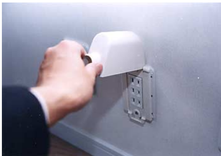
【建物写真（「LC本所吾妻橋」感電防止カバーを取り付けたコンセント）】
