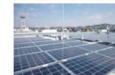
マンション屋上の 太陽光発電システム
