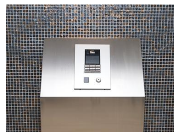
オートロック操作盤
