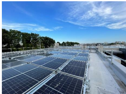
太陽光発電設備
